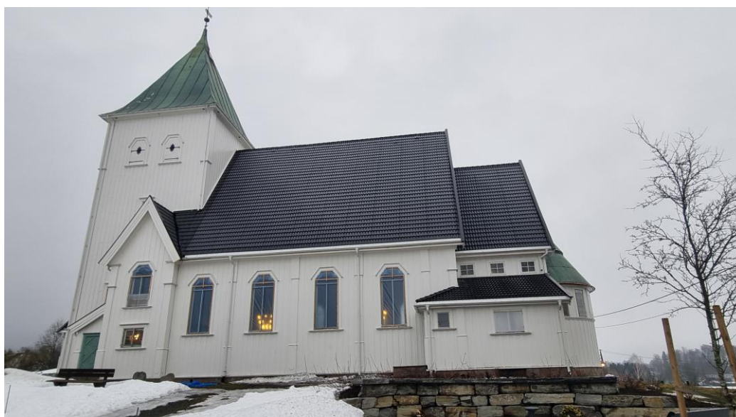
Frogner kirke, Lillestrøm - oppført 1925 og listeført som særlig bevaringsverdig, har fått solceller på taket. Foto: Harald Ringstad.
