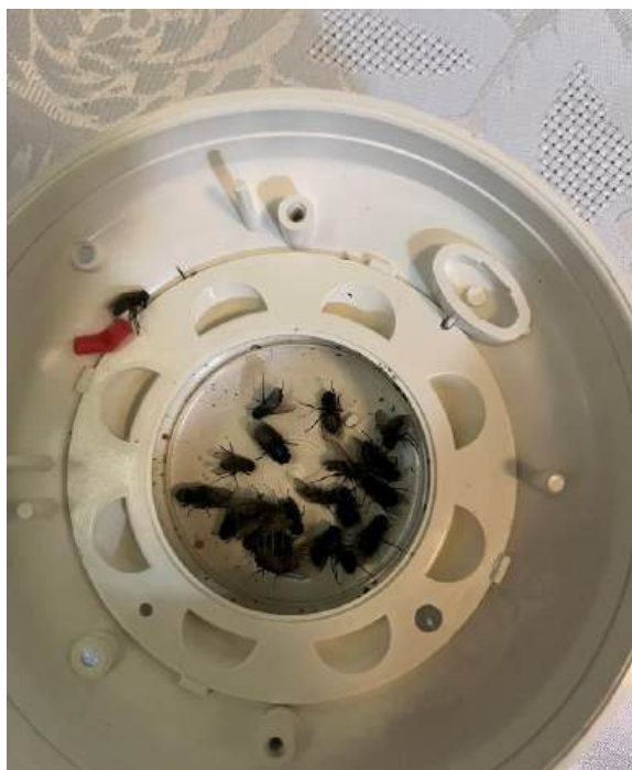
Fluer flytter inn og slår ut alarmanlegg, Tennes Foto: Kirkevergen
