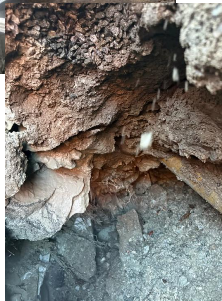
Synkehull tett ved kirkeveggen
