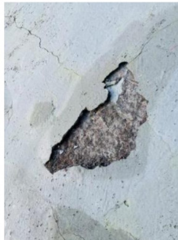
Bilde 29, malingen har sprekker og holder på fukt framfor å beskytte den porøse betongen under.
