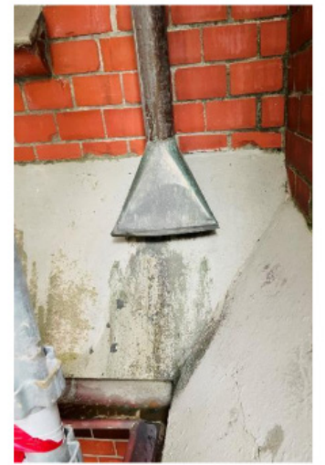
Bilde 58, Direkte fuktpråkjenning på utette betongavdekninger gir fuktinntrengning.
