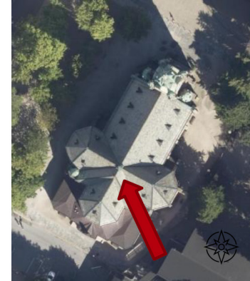
Bilde 2, Oversiktsbilde av Johanneskirken orientert i forhold til himmelretning. Rød pil viser dominerende vindretning. Hjørnet på tårn mot sør-øst viser størst skader, se pil. (1881.no, 2023)
