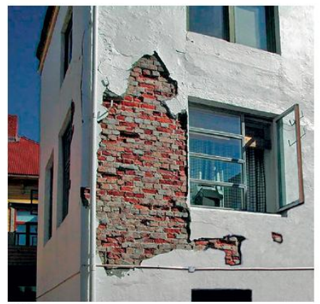
Fig. 0 Eksempel på resultat av for sterk puss på svakt underlag. Frostskafer på teglmurverket har oppstått etter at pussen har løsnet. Foto: SINTEF Byggforsk
