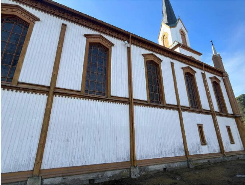
Nordveggen med svertesopp på overflatene
