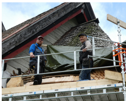
Halvor Bjåland (t.v.) og Aksel Andersen i arbeid med spontaket på gamlekyrkja.
