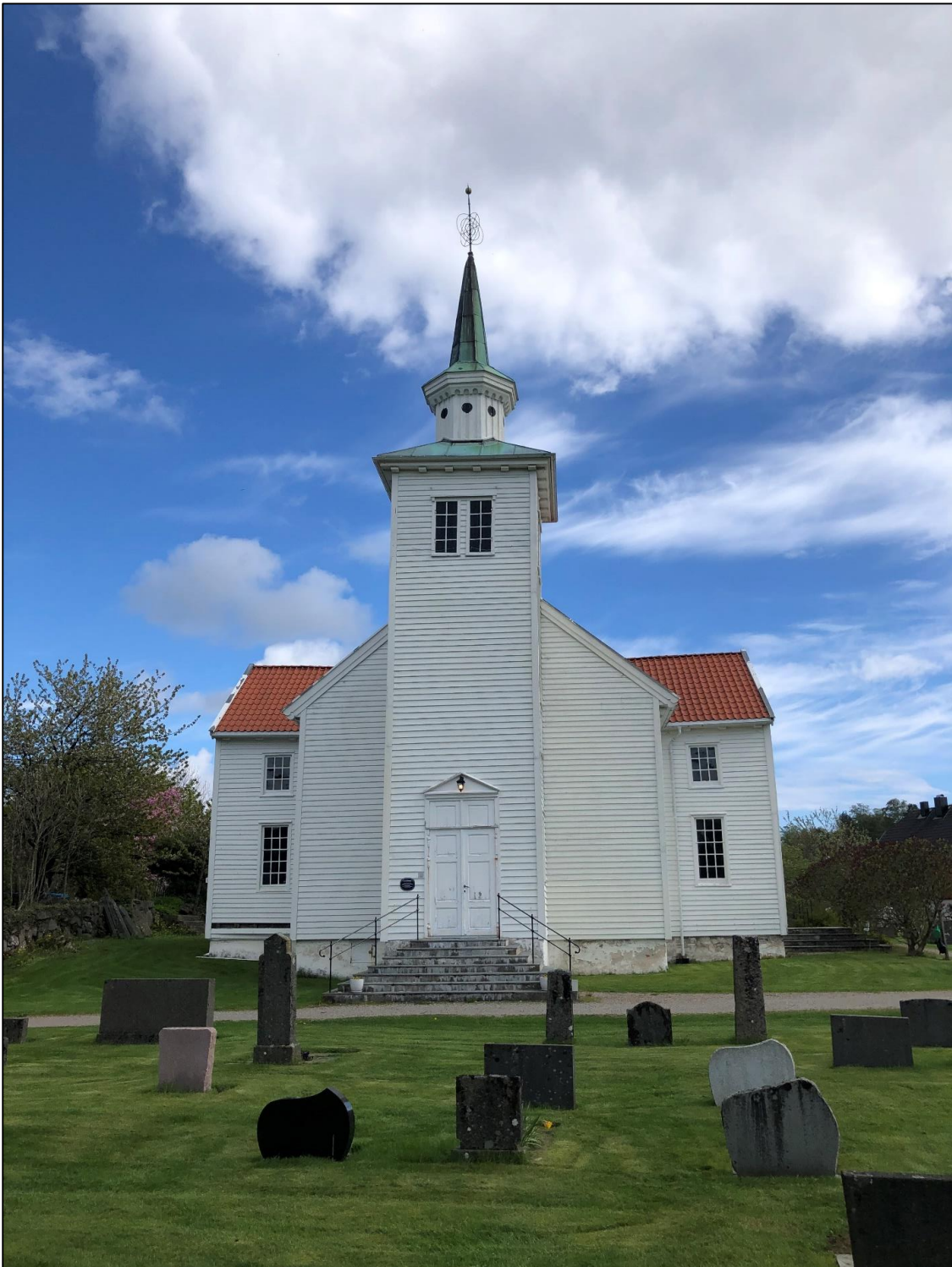
Fotovedlegg - skader i klimaskallet Spangereid kirke
