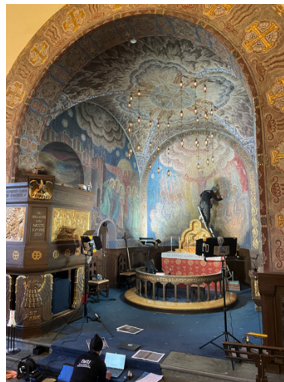
Norsk institutt for Kultur og Utsmykning (NIKU) kartlegger skader i kormaleriet.
